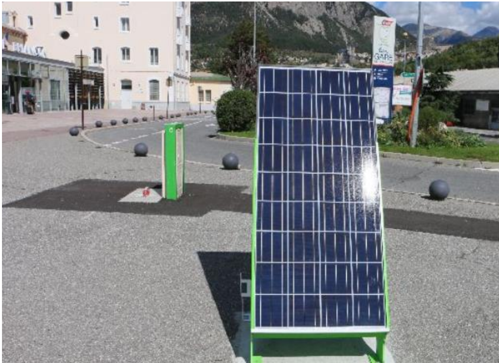
Esempio di pannello per l'alimentazione di colonnine di ricarica presso la stazione di Briançon (Fonte foto: Citec)
