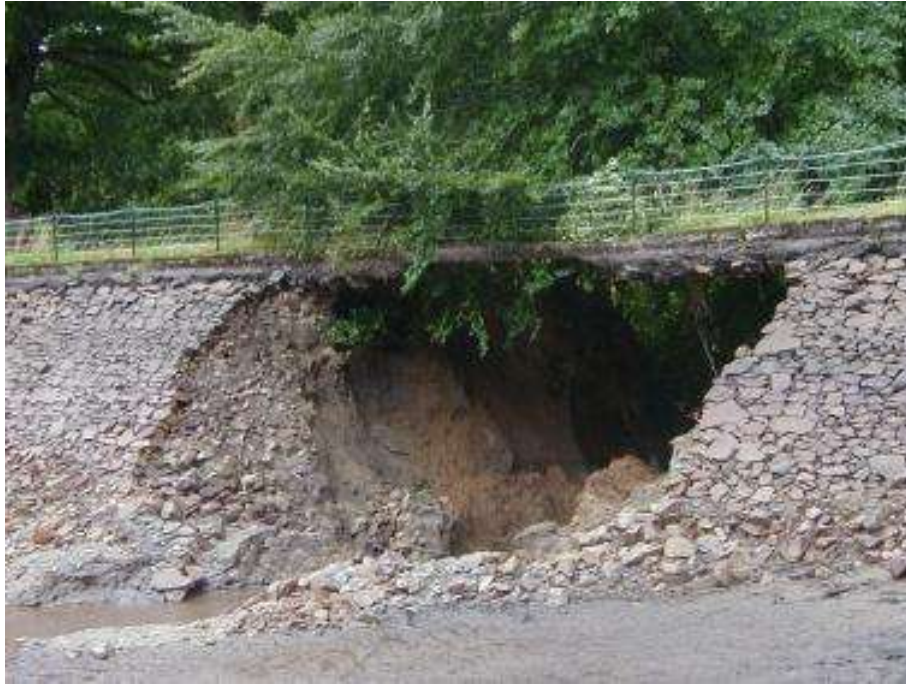
Figure 4 : Brèche initiée par le mécanisme d'érosion de contact sur le barrage des Ouches (Source : INRAE)
