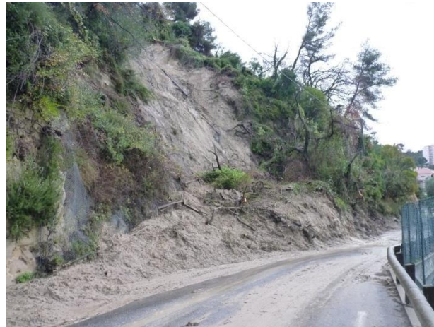
Figure 27 : Pr 2+510 : rapport géotechnique de réparation
