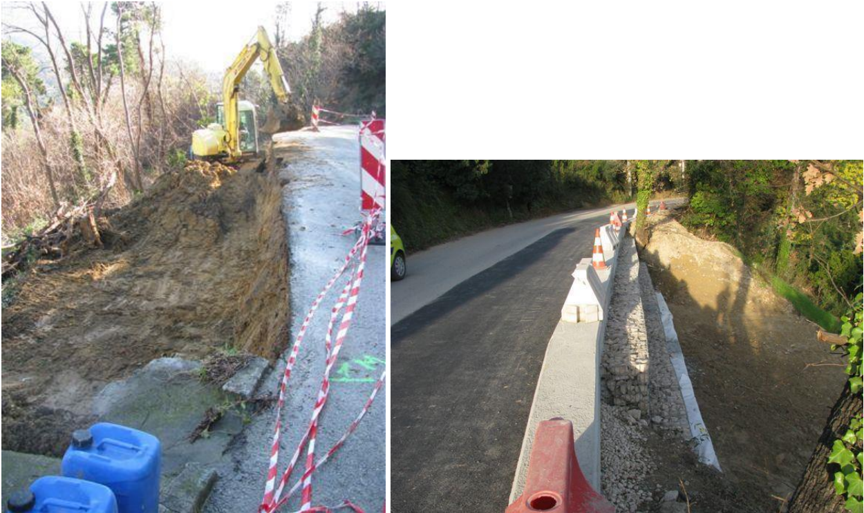
Figure 20 : PR 4+750 : pas d'infos. Réparation avec des gabions Figura 20 : PR 4+750 : nessuna informazione. Riparazione con gabbionate
